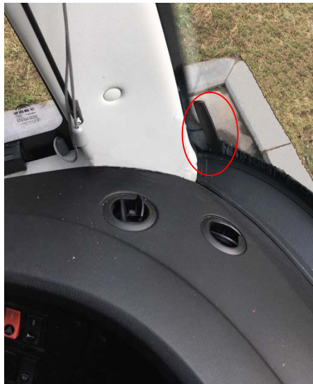
Figure 2-24 Instalación interior de Antena de Red Móvil
