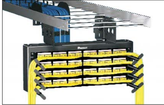
Montado en el escalón central por debajo y en perpendicular al soporte del enrutamiento tipo escalera
