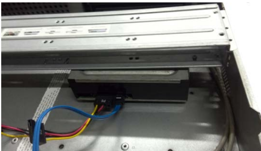
Figura 3-46 Cables de conexión
