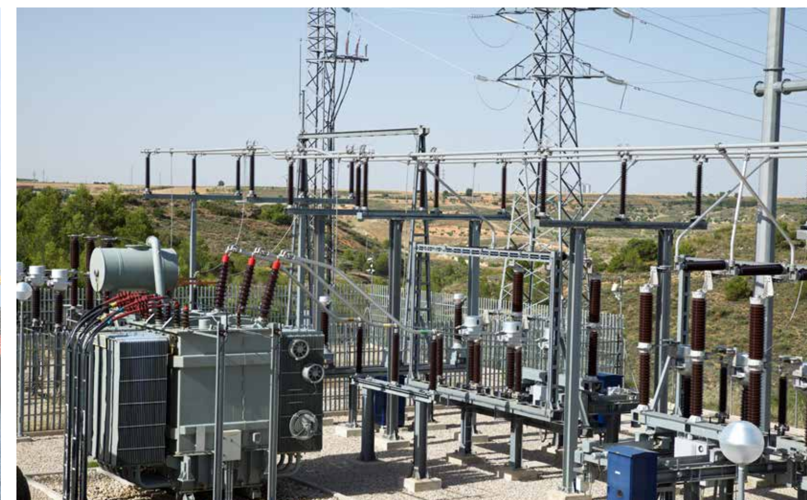
Subestaciones eléctricas (España)
